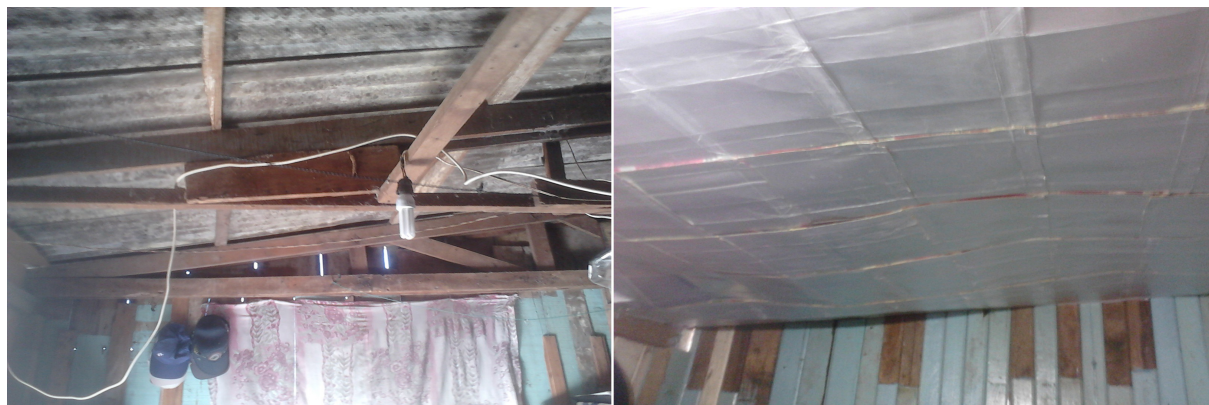
Figura 1- Fotografia de uma das residências onde os painéis foram instalados. (a) Antes da instalação; (b) Depois da instalação.
