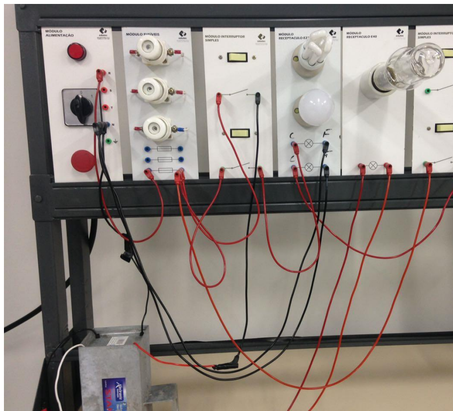
Figura 1 – Ligação das Lâmpadas LED, Compacta e Vapor Metálico
