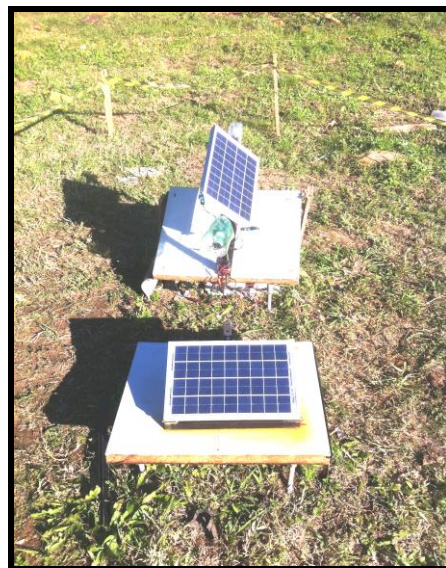
Figura 3 - Sistema fotovoltaico de base fixa e de base com sistema rastreador solar.
