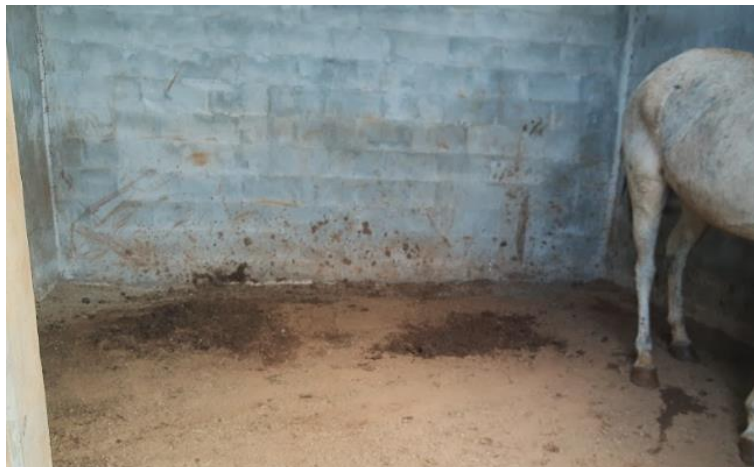
Figura 1. Umidade na baia do cavalo
