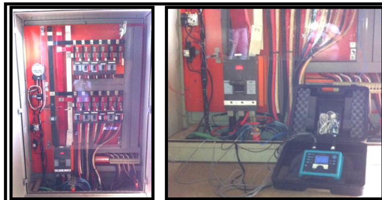
Figura 2 – Instalação do analisador de energia no quadro geral de distribuição e de proteção.
