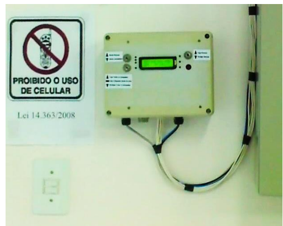
Figura 6 - Caixa de comando instalada na parede do laboratório, próxima ao interruptor que agora não é utilizado.
